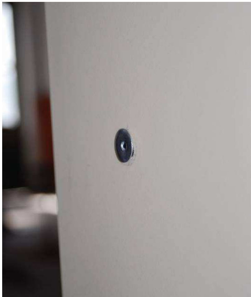
Obr. 3 Zábradlí s výplní FUNDERMAX, dopadová energie 150 J Detail povytažení hlavy jednoho z nýtů, stav ostatních nýtů byl podobný
